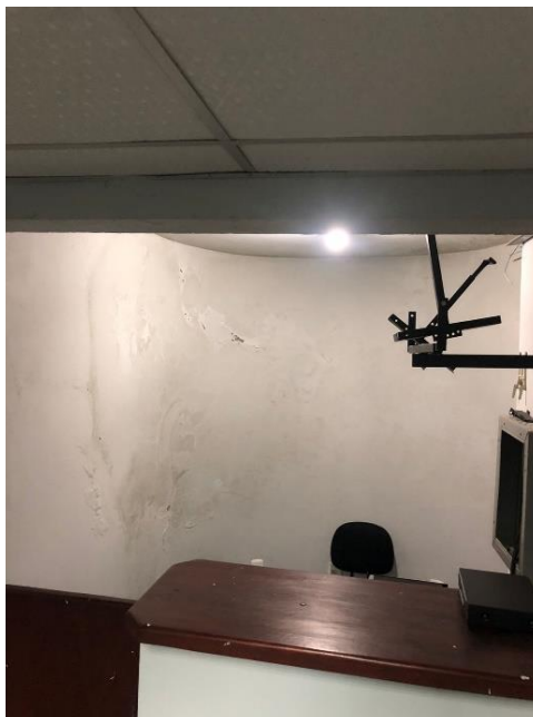
Foto 2: Sala do projeto com infiltrações
