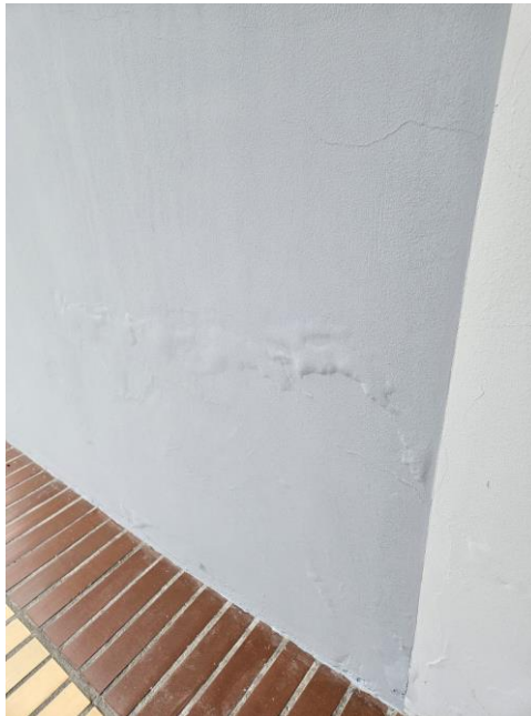
Foto 7: Paredes do auditório com infiltrações
