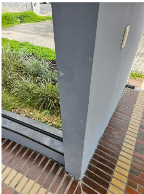
Foto 6: Paredes do auditório com infiltrações
