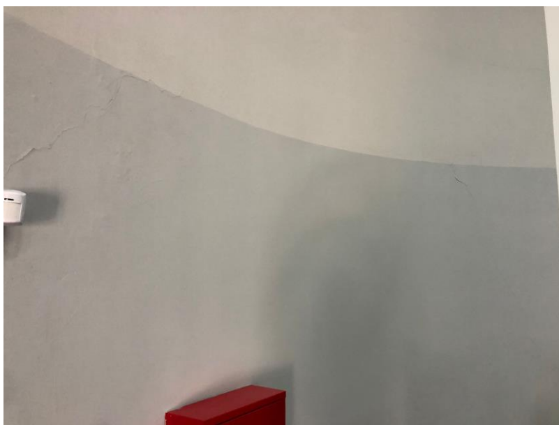
Foto 3: Paredes do auditório com infiltrações
