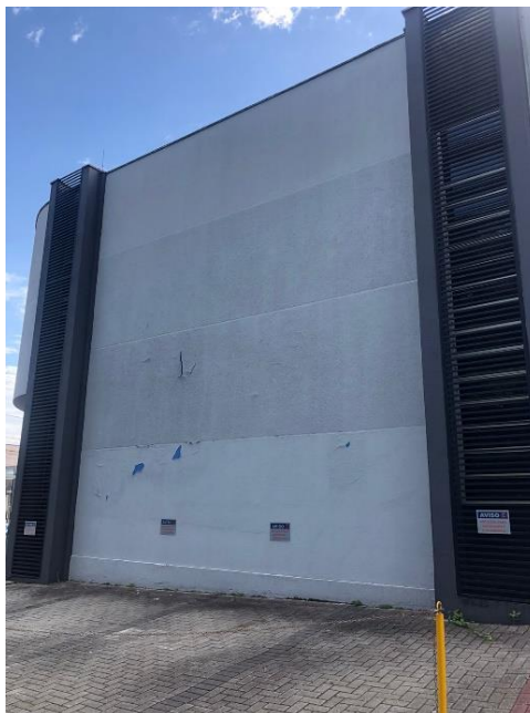
Foto 1: Textura soltando na parede externa
