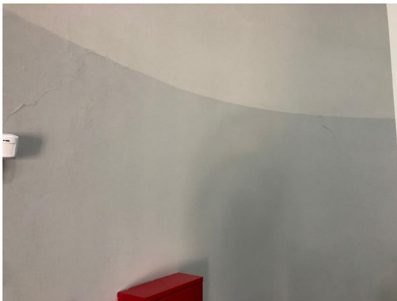
Foto 3: Paredes do auditório com infiltrações
