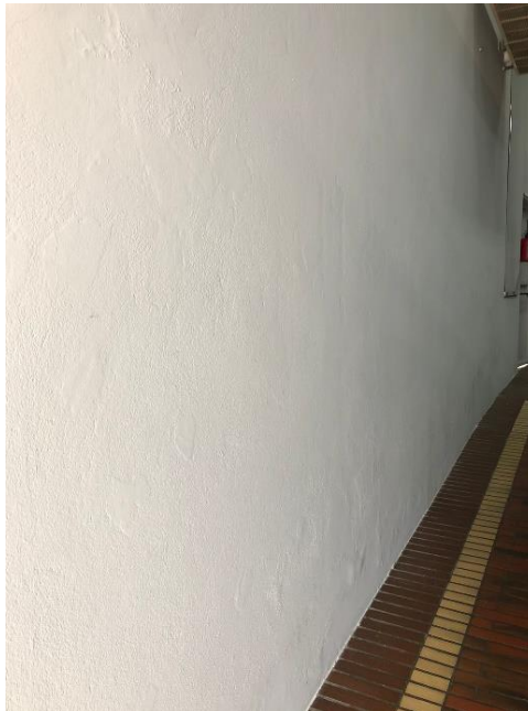
Foto 4: Paredes do auditório com infiltrações
