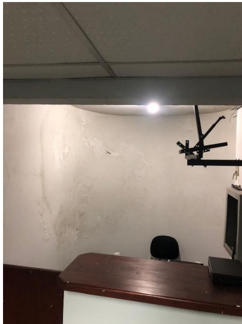
Foto 2: Sala do projeto com infiltrações
