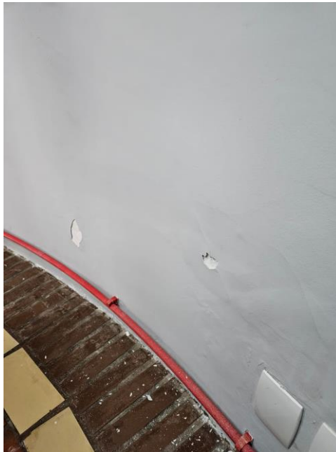
Foto 6: Paredes do auditório com infiltrações
